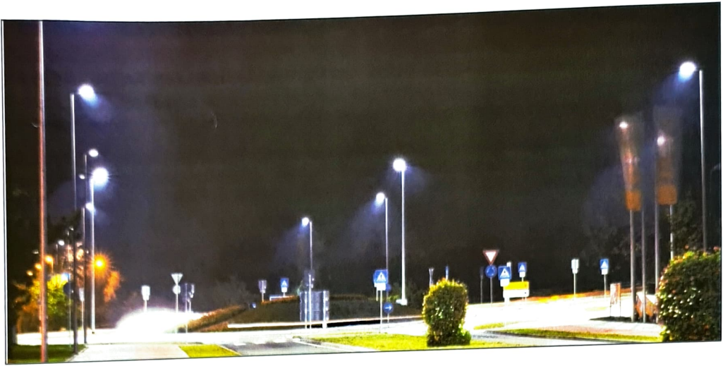
ภาพที่ ตัวอย่างรูปแบบการติดตั้งโคมไฟถนนอัจฉริยะพลังงานแสงอาทิตย์
